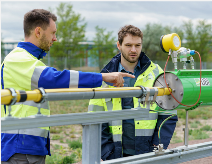
Bild 6: Die HYPOS-Projektverantwortlichen Martin Glas (links) und Patrick Becker an der Permeationsmesszelle an der Rohrbrücke
