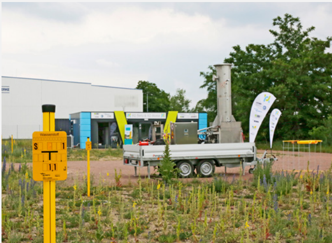
Bild 3: Die Fackel sorgt für eine umweltschonende und sichere Verbrennung des Wasserstoffs
