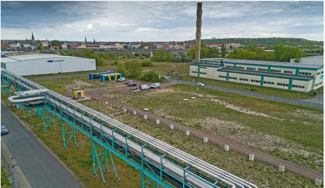
Das Testgelände im Chemiapark Bitterfeld-Wolfen wird von der Linde AG über eine Rohrbrücke mit Wasserstoff versorgt
