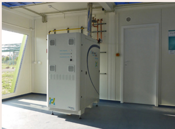
Bild 10: H 2 -BHKW in Versuchsumgebung auf H 2 -Netz Versuchsgelände
