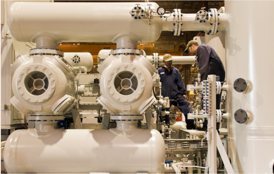
Bild 3: Typische Kolbenverdichterinstallation in 4-Zylinder Boxeranordnung mit saug- und druckseitigen Pulsationsdämpfern zur Erdgasverdichtung
